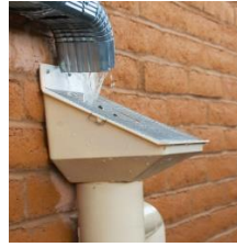
تجميع وتصفية مياه الامطار
