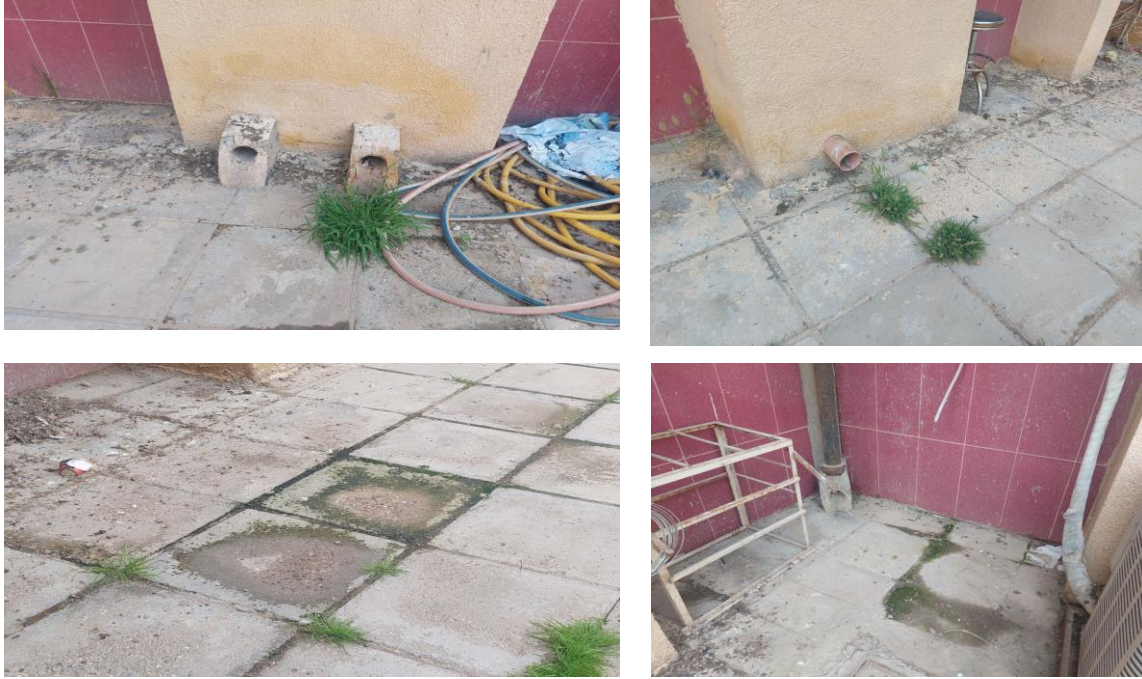
شكل (3): يبين الاضرار الناتجة من مياه اجهزة التبريد والمرازيب المصدر الباحثان
